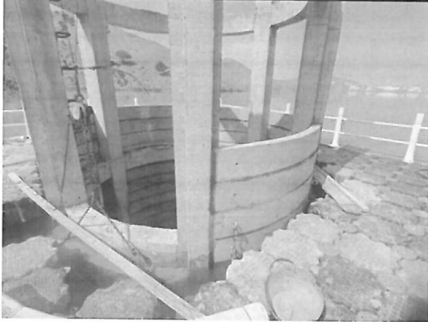
图 3.2.2-1 排水井外观现状照片
